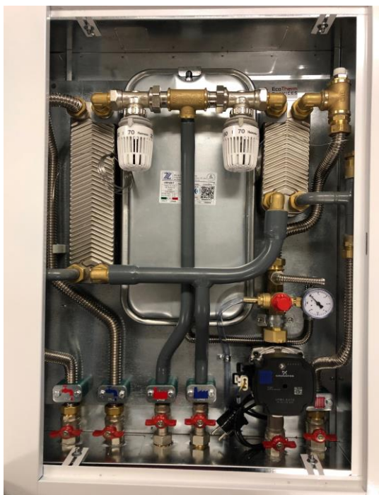
Imaginile pot varia funcție de tipul și componenta substației alese.
